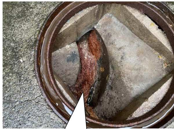
桝の中に侵入した木の根
