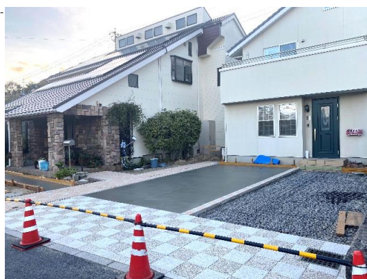
インターロッキング施工の後、駐車部をコンクリートで仕上げます。半面コンクリートを仕上げた所です。
