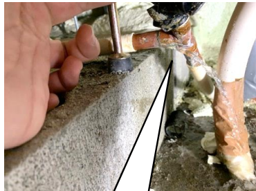
給湯管から漏水しています。
