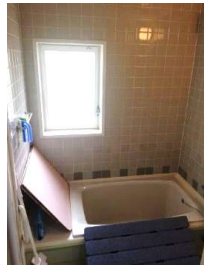
25年前のユニットバスは断熱材が無く、窓も経板ガラスなので冬はとて寒いお風呂です。
