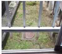
屋外汚水放流桝
