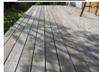
風雨にさらされて シルバーグレーに変色したウッドデッキ
