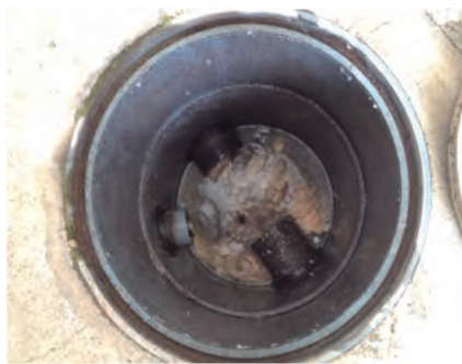
300φの防臭桝、油分が固まっています。見やすくするため、防臭用のエルボは外しています
