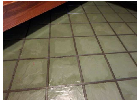
土間タイルの結露
