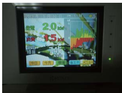
発電モニター
