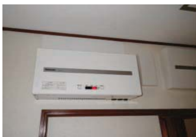
パワーコンディショナー (発電した電気を交流に変換します)
